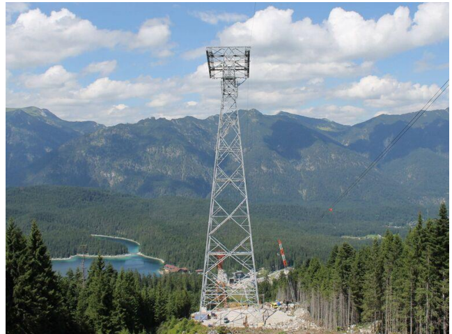
Dieser Mast ist 127 Meter hoch. Das ist die höchste Fachwerkstütze der Welt.
